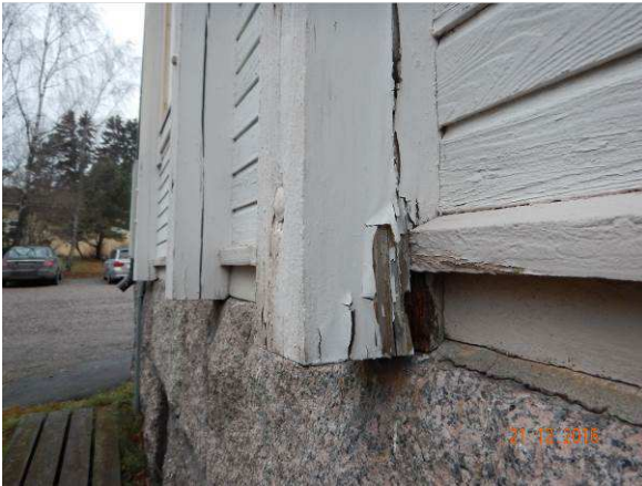
Lahovaurio julkisivun puuosalla.
