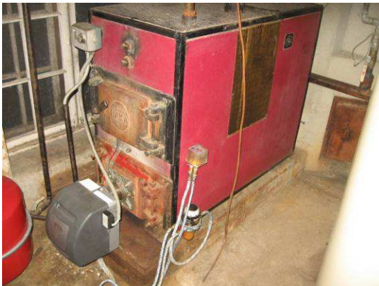
Lämmityskattila ja öljypoltin
