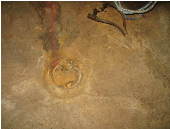
Kattilahuoneessa huonokuntoinen lattiakaivo
