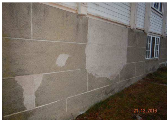
Rapatun sokkelin alareunassa kosteusjälkiä.
