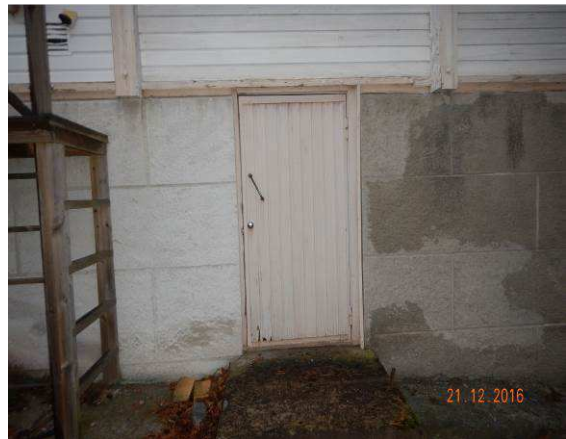
Puuovi maalipinnoiltaan kulunut.
