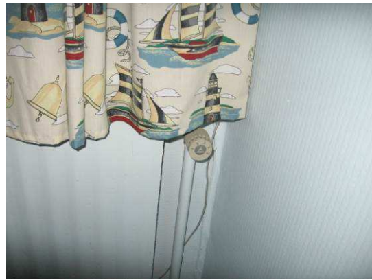
Vanha Danfosin termostattinen patteri- venttiili
