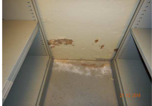
Kosteusjälkiä arkistohuoneen lattiassa.
