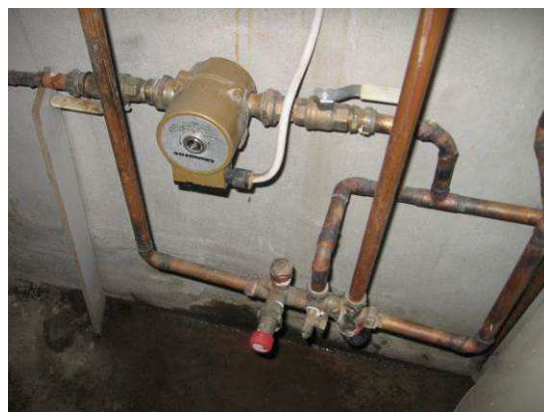
Lämpimän käyttöveden lämpötilasäädin alhaalla oikealla
