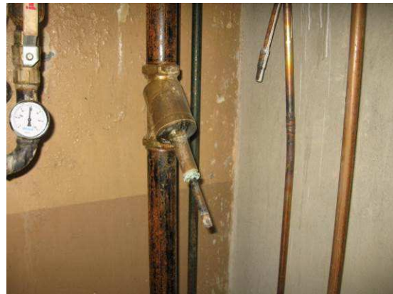
Kattilahuoneessa vanha istukkaventtiili
