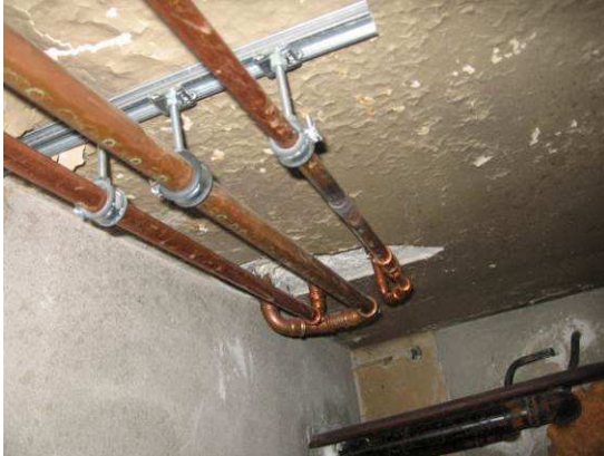
Eristämättömiä vesijohtoputkia kattilahuoneessa
