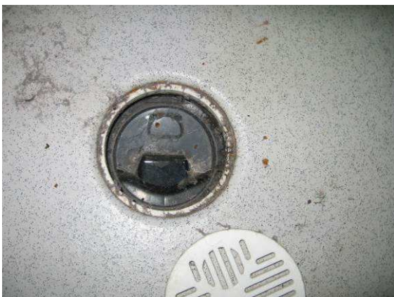
Muovinen lattiakaivo pesuhuoneessa
