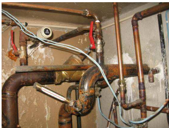
Eristämättömiä lämpöjohtoputkia kattila-
