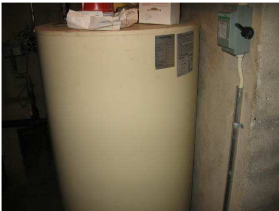
Lämpimän käyttöveden varaja
