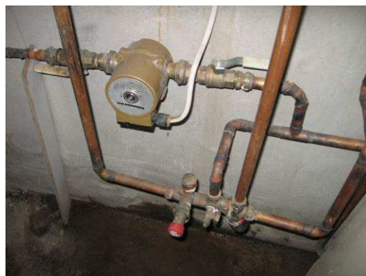
Lämpimän käyttöveden kiertovesipumpu ja palloventtiileitä
