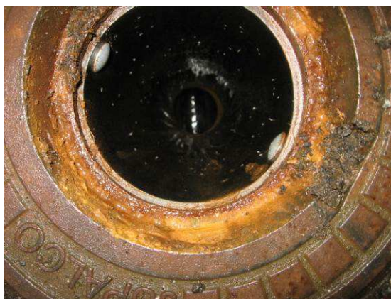
Pihalla viemäriin tarkastusputki
