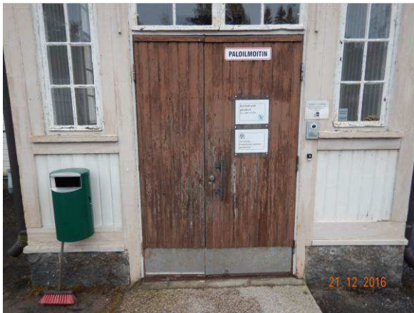
Pääovessa pinnoitteen kulumaa.
