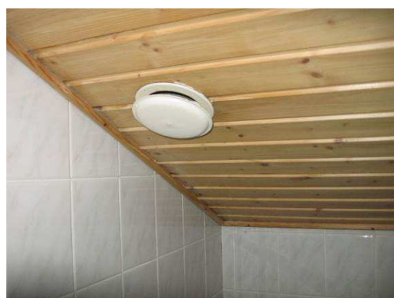
Toisen kerroksen wc-tilassa lautasventtiili
