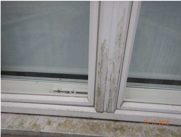
Uusitun puuikkunan ulkopinnalla kulumaa ja liikaantumaa.
