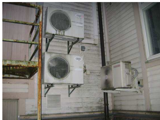
Kompressoriyksikköjä takapihan seinällä
